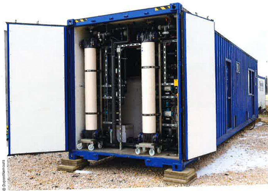
L'unité pilote d'ultrafiltration Inge, mise en place en 2019 à la station de traitement des eaux usées de Steinhäule à Neu-Ulm en Allemagne, après un réacteur de contact à charbon actif, a montré les avantages de combiner les deux technologies.
