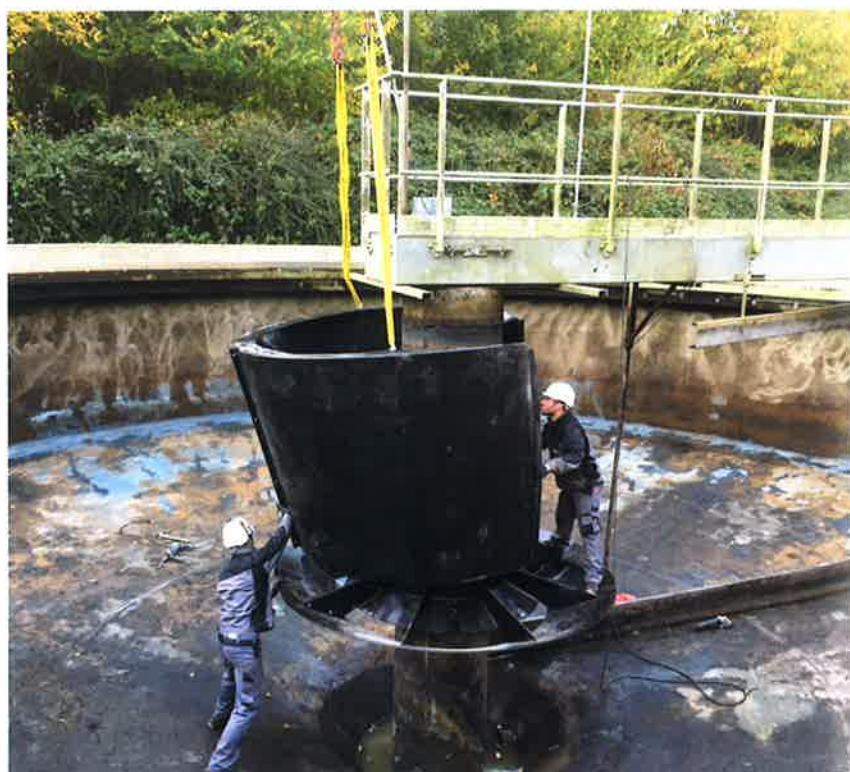
Clarificateur équipé du SPEED-O-CLAR™ de Densiline-steu de Lanvollon
