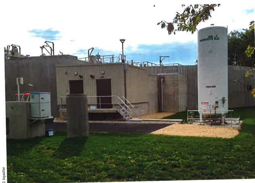
À Saint Pourcain sur Sioule, le traitement des micropolluants développé par Aqualter repose sur une technologie d'ozonation complétée d'une biofiltration sur argile expansée.
